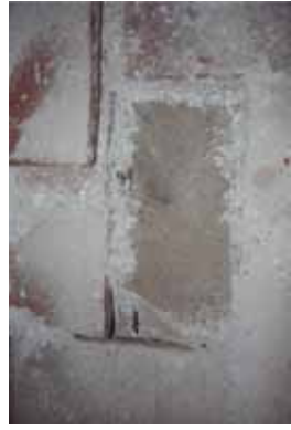
PAVIMENT 1-5 No recuperable
